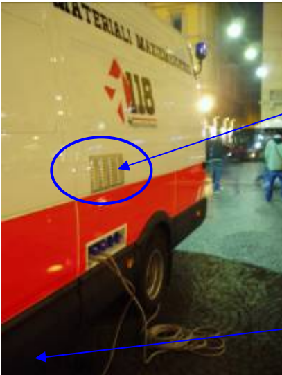
PRESA D'ARIA ESTERNA del motogeneratore
